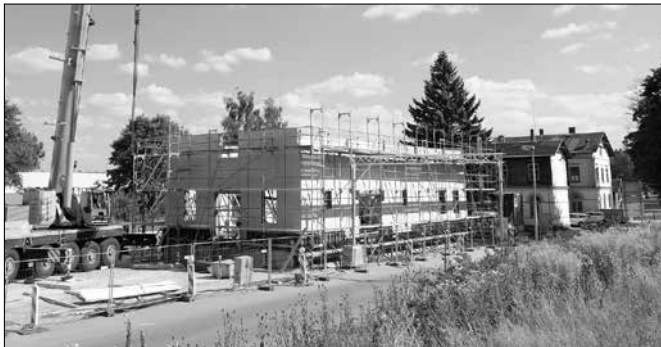
Medienversorger des Digitalen Testfeldes (ehemaliger Güterboden) – Richtfest am 26. August 2022
