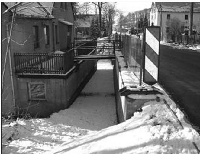
Stützmauer am Haus Nr. 25, Foto Herr Ralf Schuster
