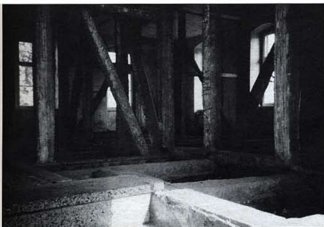
unten: Balkenwerk durch braunen Kellerschwamm, Pilze und Insektenbefall beschädigt
