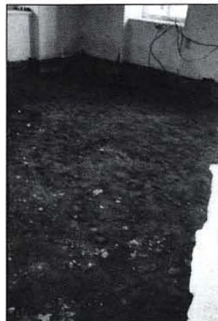
rechts: Schwarzsimmel und Algenbefall im gesamten Gebäude
